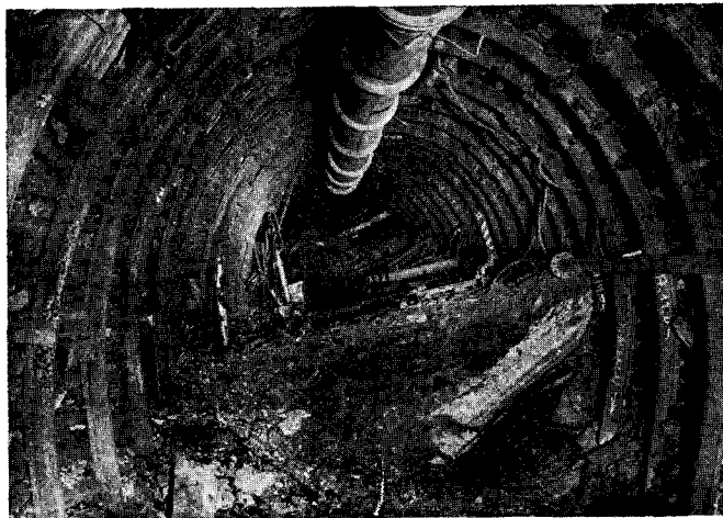
Abb. 1. Bankig aufgeschobene Streckensohle in 900 m Teufe (Gleitbogenausbau).
