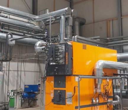
Heizzentrale mit einem 900 kW Hackschnitzelkessel
