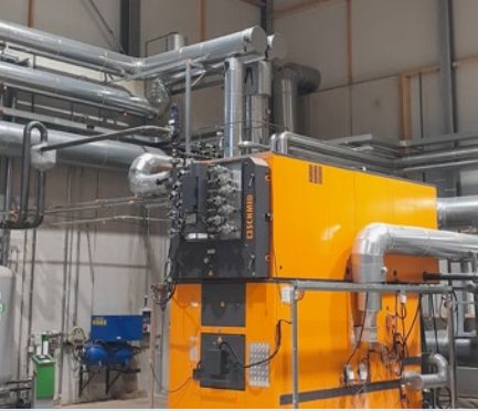
Heizzentrale mit einem 900 kW Hackschnitzelkessel
